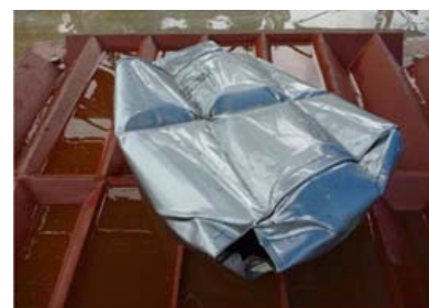
未塗装の損傷状況
