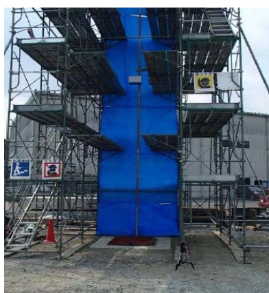
落下衝撃試験構台
